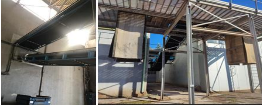
Слика 47 Транспортни ленти кои излегуваат од халата и истоварни ленти за стабилизирана фракција Во просторијата, на неколку места има дамки на подот од истекување од горива/масла и сл.
