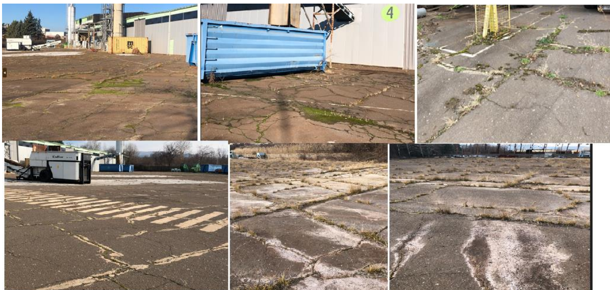
Слика 97 Пукнатини на дворната површина
